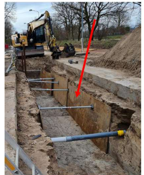
foto 2 foutief toegepaste materialen t.b.v. de sleufbekisting de combinatie van de stempels met de rijplaten is onjuist
